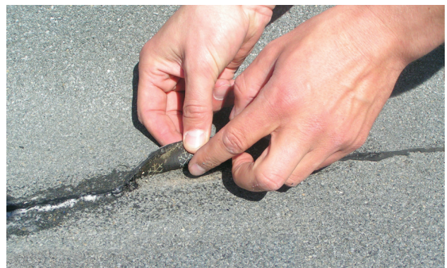
3 pav. Stogo dangos siūlės suirimas
